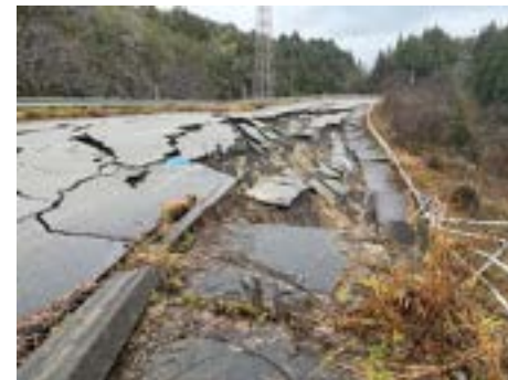
石川県七尾市 道路被害 （1月9日）
