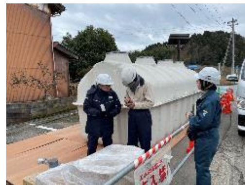
能登町での浄化槽の状況確認
